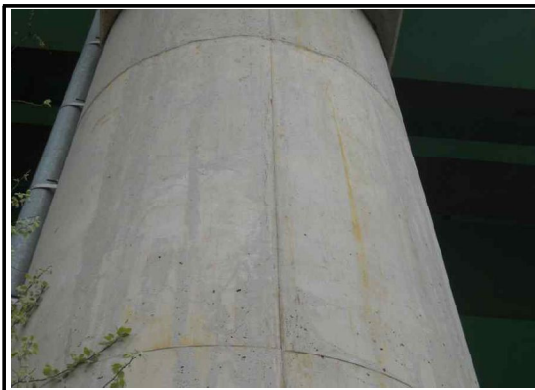
P5 기둥부 균열
