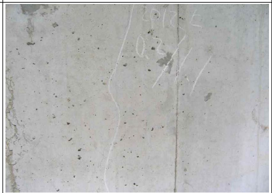
P8 코핑 균열
