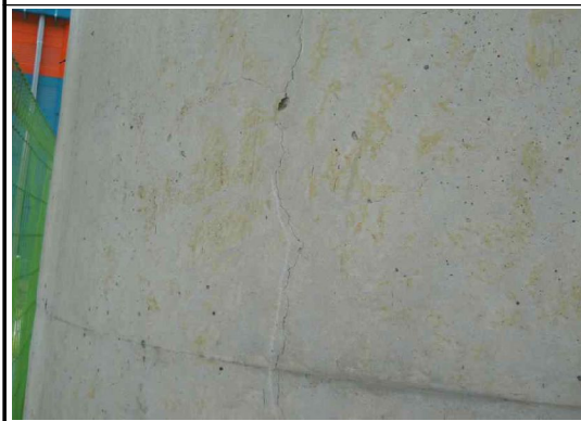
P7 기둥부 균열
